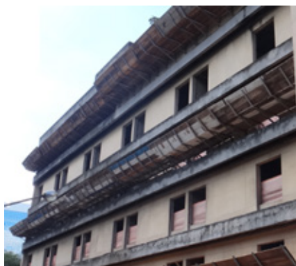
Figura 90 - Plataformas de Proteção - Bandejas
