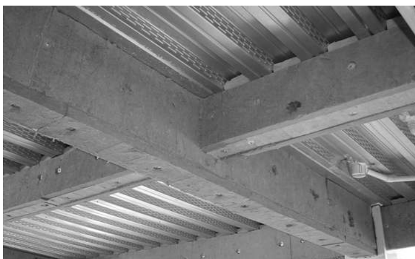
Figura 54: Vigas protegidas por lã de rocha basáltica.
