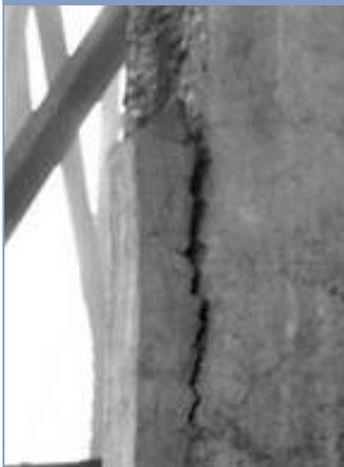
Figura 40 - Lascamento explosivo (spalling) em pilar de concreto.
