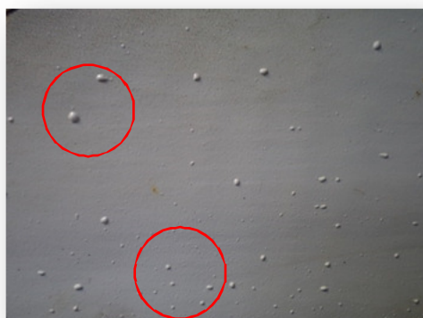
Imagem 8: Exemplo de revestimento agredido ao longo de ensaio de umidade, bolhas em destaque.
