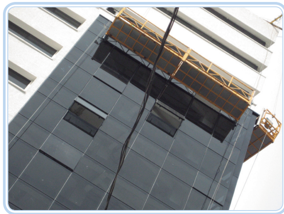
Figura 20.1: Andaime em pavimento alto
