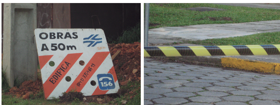
Figura 2.1: Equipamentos de proteção coletiva
