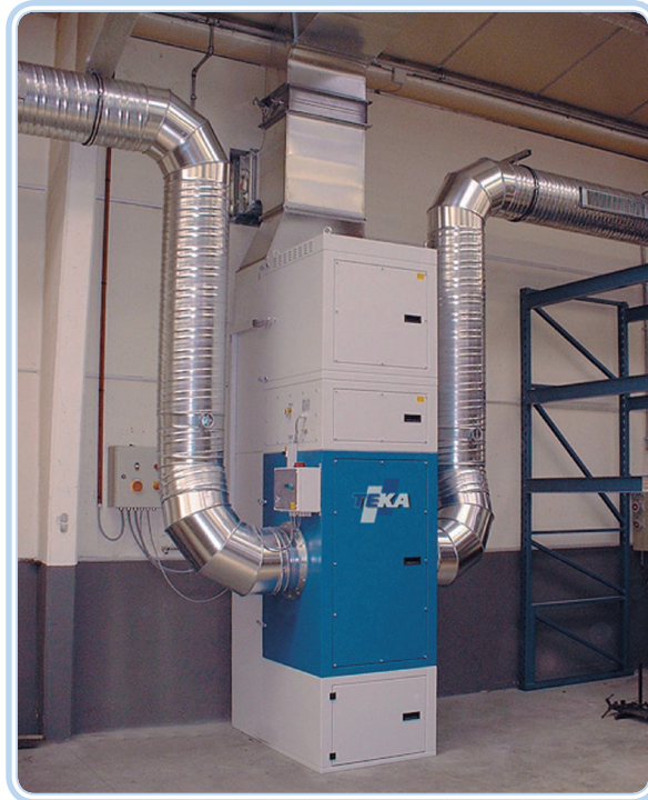
Figura 8.5: Ventilação local exaustora.
