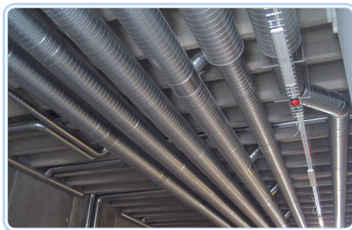
Figura 6.1: Ventilação industrial. Fonte: ©FredrikT/Wikimedia Commons.
